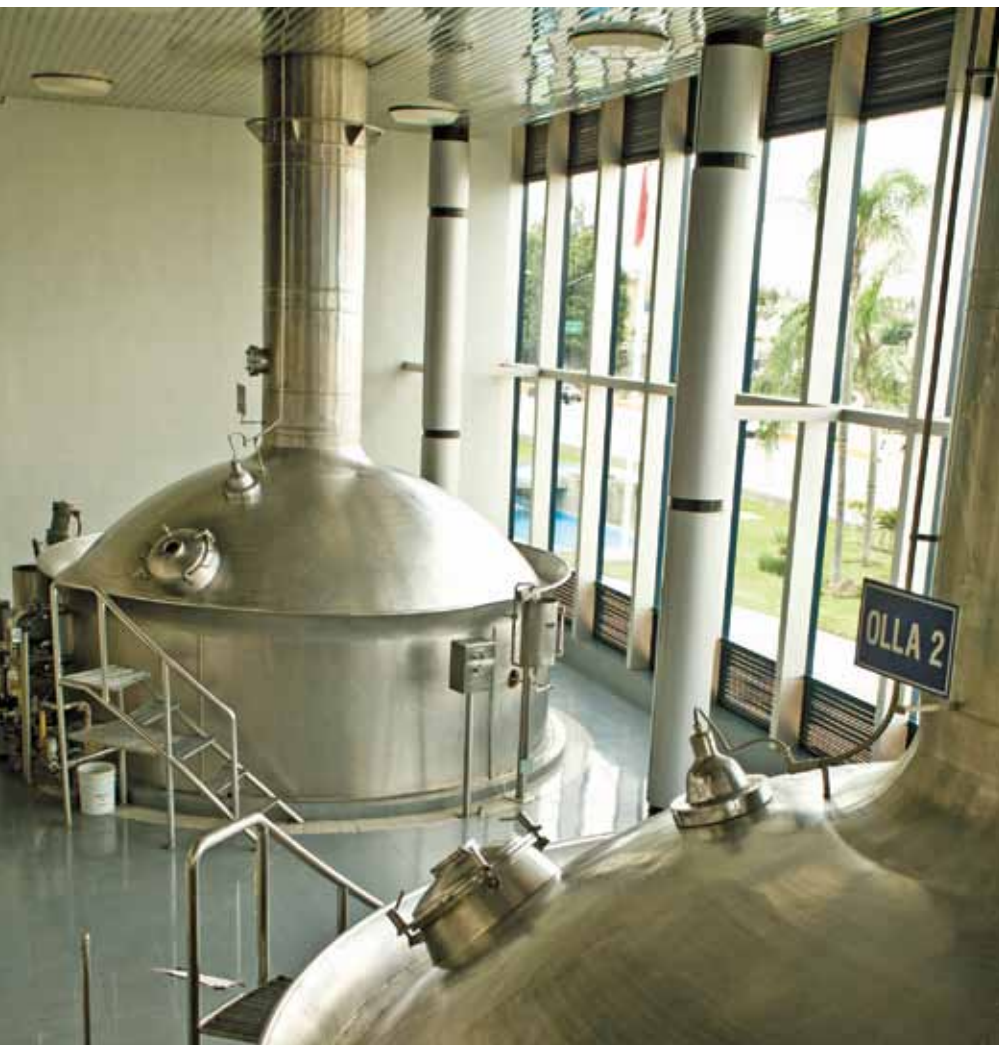
Tuberías y tanques para fabricar cerveza en la cervecería Corona.
